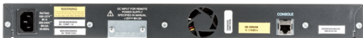
Figura 2- Trasera de un switch Cisco. Atención al puerto “CONSOLE”
